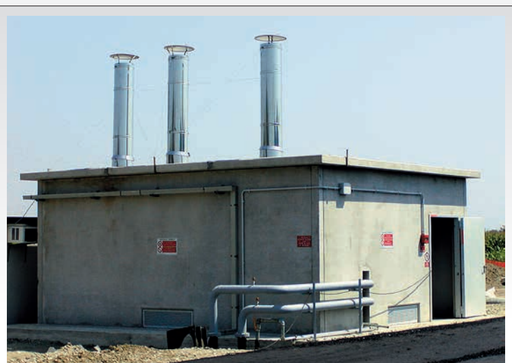
Hot water unit with 3 boilers for a total power of 750,000 kcal/h Centrale termica con 3 caldaie per una potenza tot. di 750.000 kcal/h
